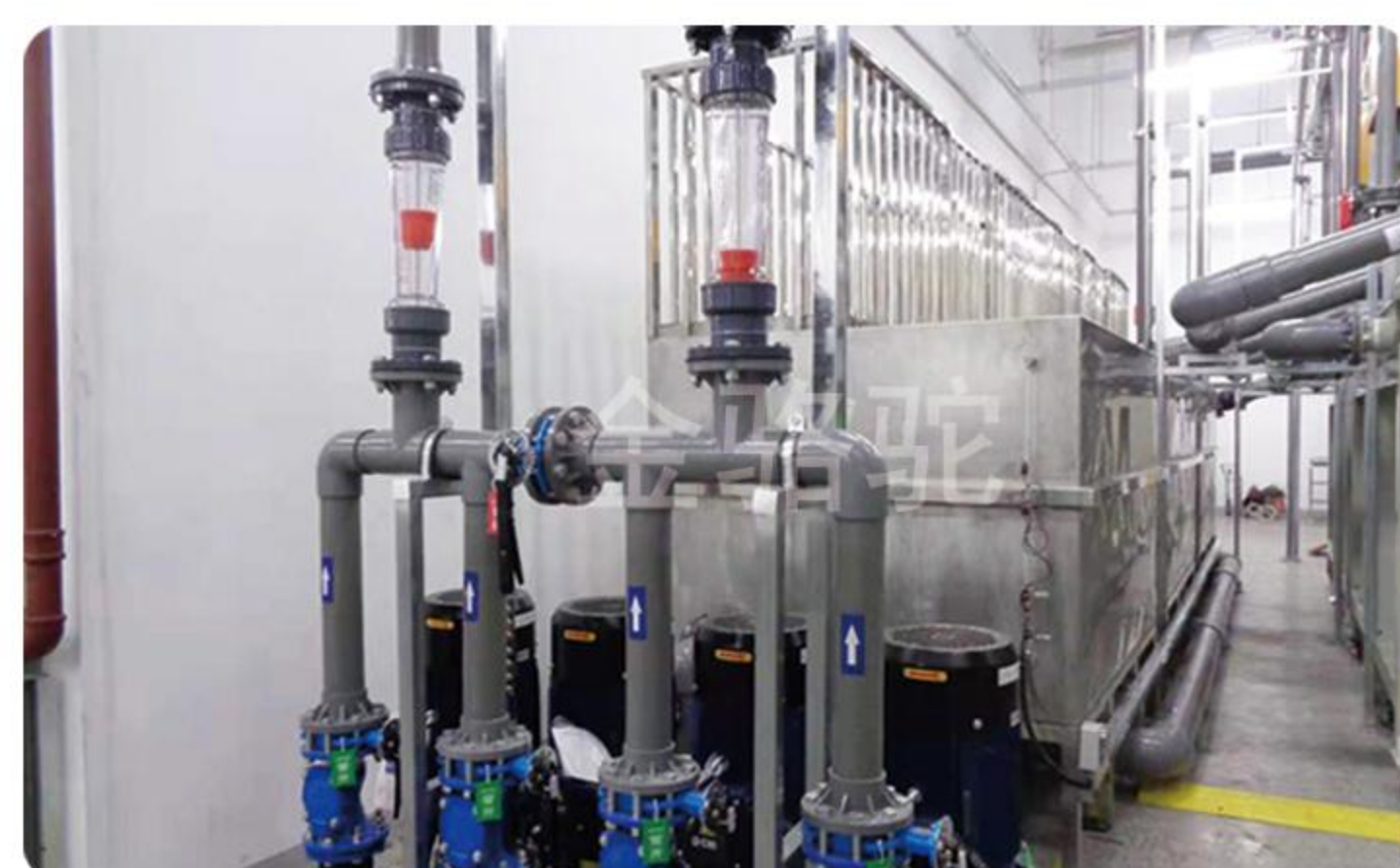
集中水箱和供液系统
